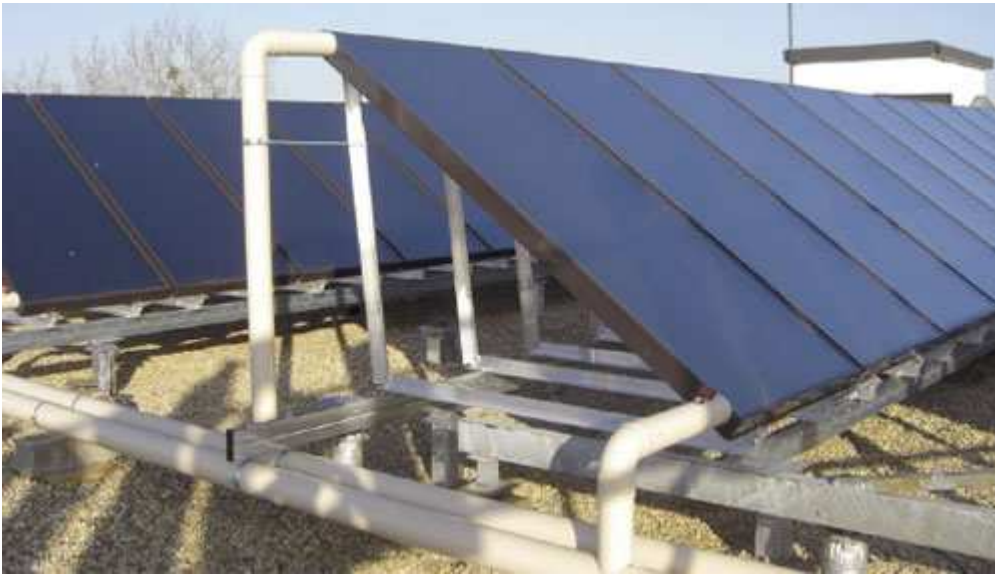
Capteurs solaires thermiques sur l'hôtel Ibis de Villefranche-sur-Saône
