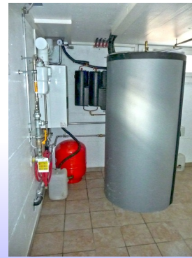
Chaufferie avec ballons solaire combi à stratification et stockage de chaleur
