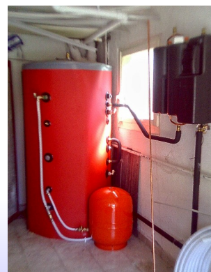
Chaufferie avec ballons solaire combi à stratification
