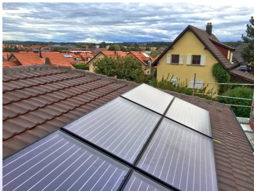
Vue en toiture du champs de capteurs Optisun 250
