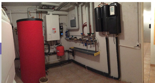
Chaufferie 1 ballons combiné à stratification et station solaire
