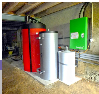
Chaudière avec ballons ECS solaire combi à stratification et stockage de chaleur
