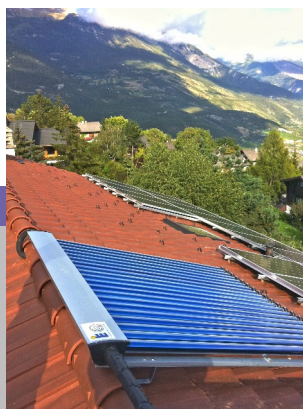
Vue en toiture du champs de capteurs sous vide
