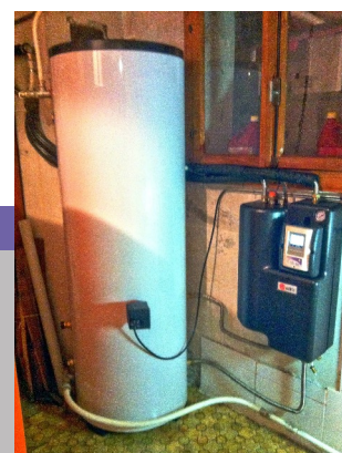
Chaudière avec ballons solaire ECS
