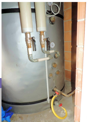
Ballon de stockage à stratification
