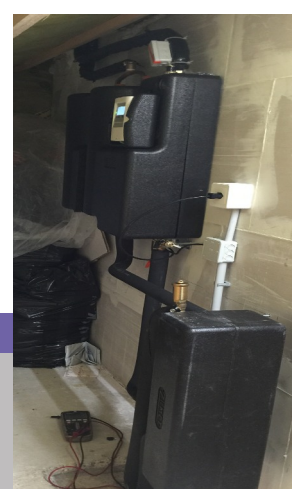
Station solaire avec échangeur à plaque
