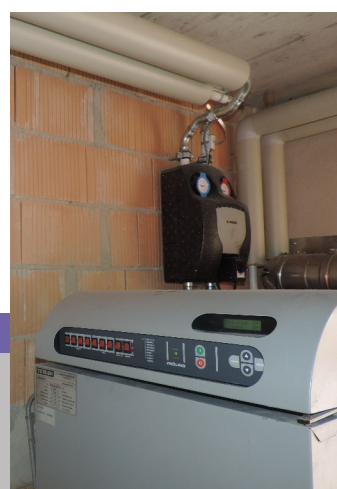
Chaudière à bois
