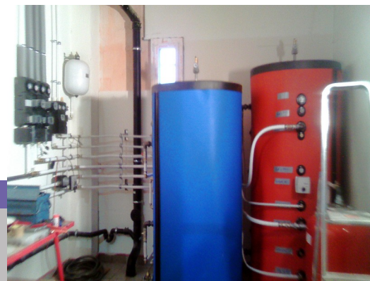
Chaudière 2 ballons de stockage de chaleur
