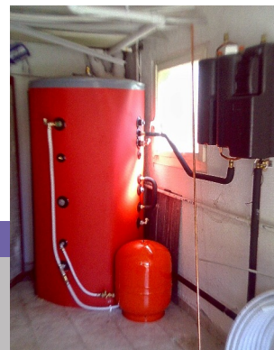
Chaufferie avec ballons solaire combi à stratification
