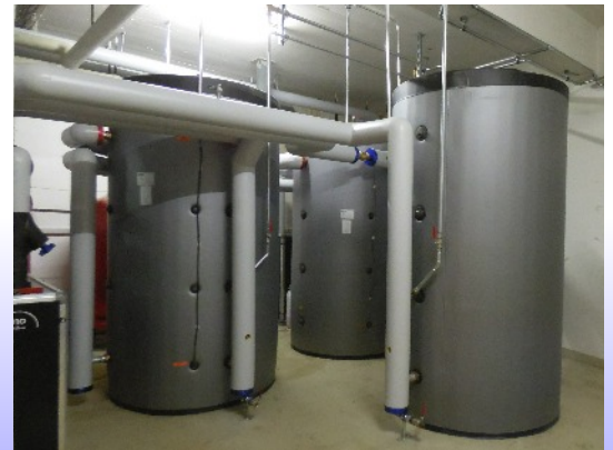
Chaufferie 3 ballons 3000 litres de stockage de chaleur
