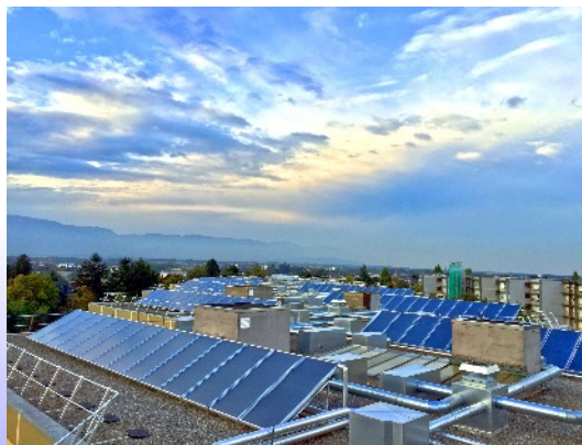
Vue en toiture des 8 champs de capteurs
